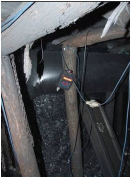
圖5-8：工作面回風道安裝的瓦斯監測儀
